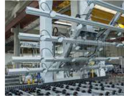
Sistema de manipulación automática de los paneles de cristal
