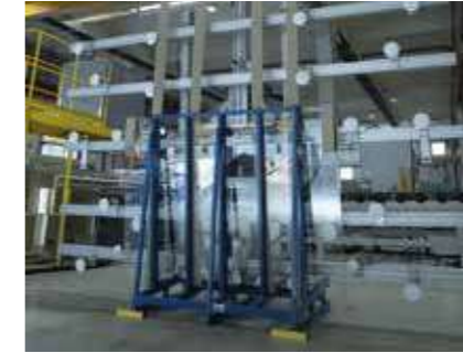
Sistemas automáticos escorredores
